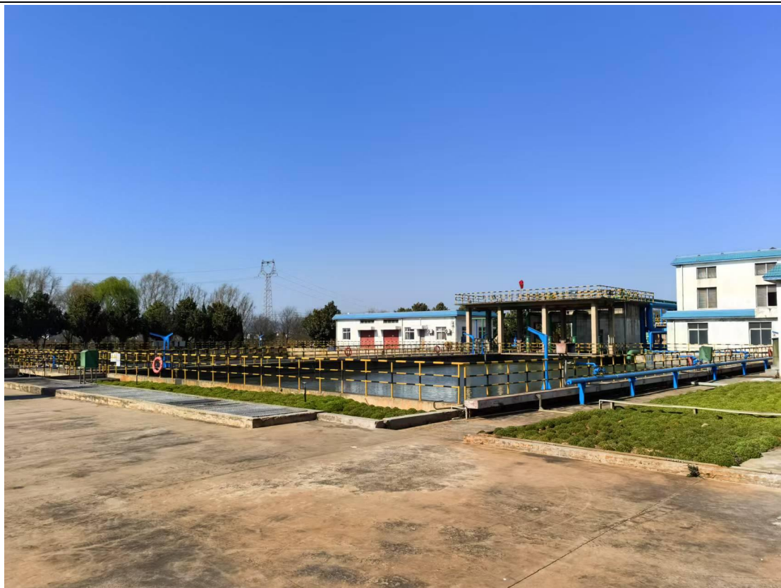
图 3 48000m 3 /d 污水处理站
